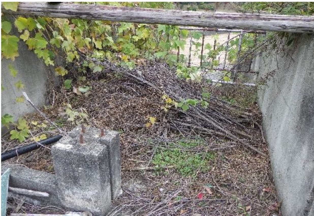
ゴミによる通水阻害
