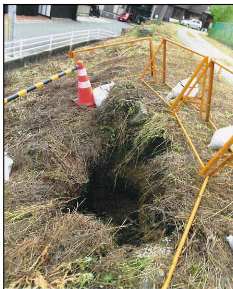
R5 豪雨災害によるため池堤体の被災 (外法の陥没現象)
