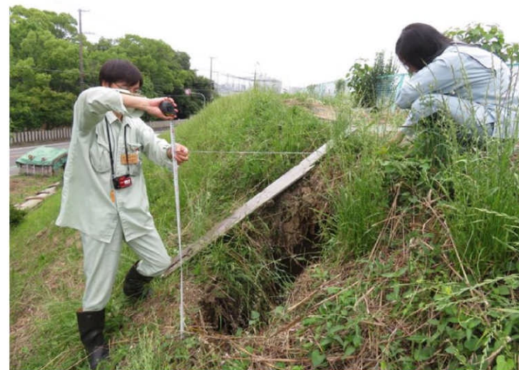
R6 豪雨災害によるため池堤体の被災 (外法の陥没現象)
