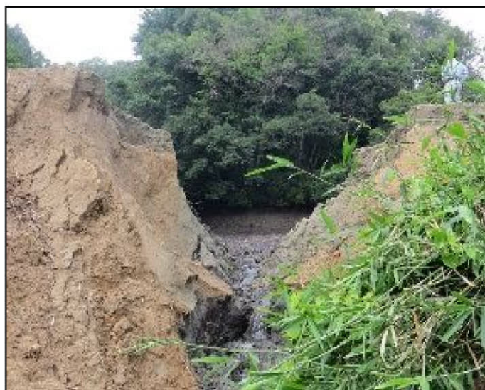
H30年7月豪雨(西日本豪雨)による ため池堤体の決壊
